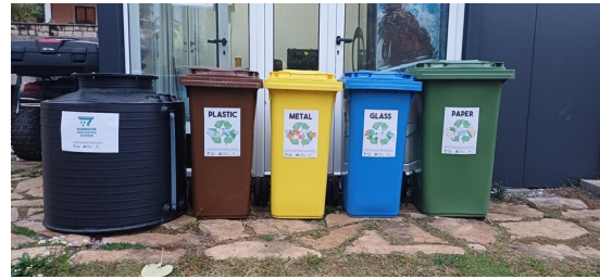
Sistem za sakupljanje kišnice i selektivno odlaganje otpada - konkretna oprema uvedena kroz projekat.
