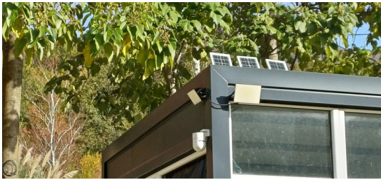
Dio opreme za energetsku efikasnost i korišćenje obnovljivih izvora energije.
